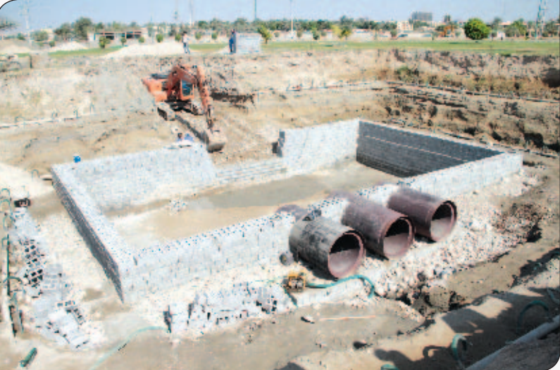
ایستگاه پمپاژ آب خور شیلات
